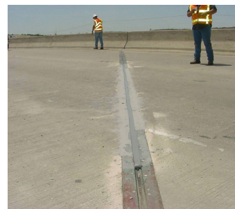
翻新后的接缝
