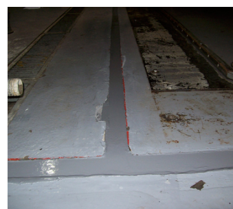
已使用贝尔佐纳(Belzona) 4521 成功修复
