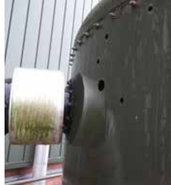
罐壁穿孔效应
