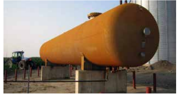
遭受外部腐蚀的容器
