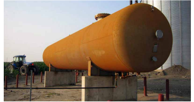
遭受外部腐蚀的容器
