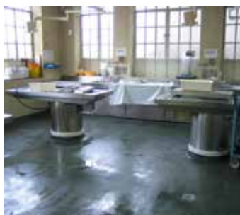
混凝土地面修复前
