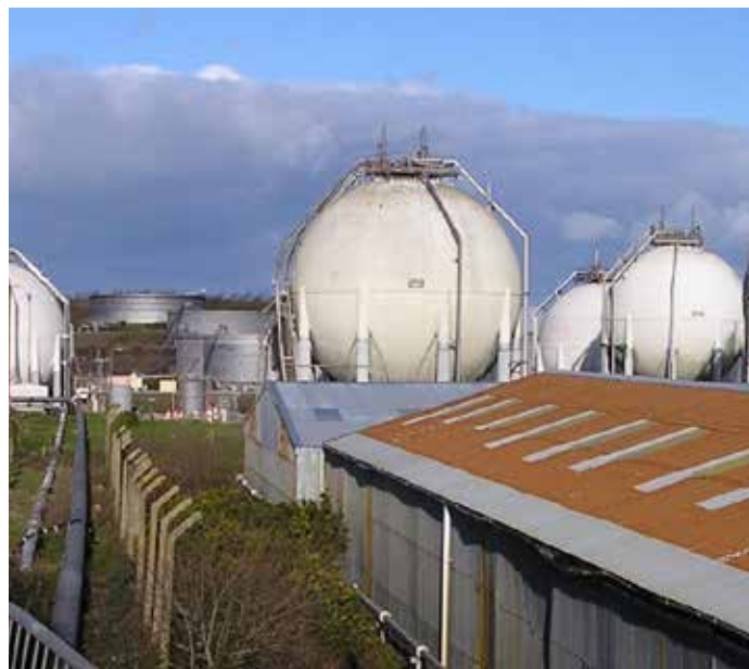
液化天然气储存球罐
